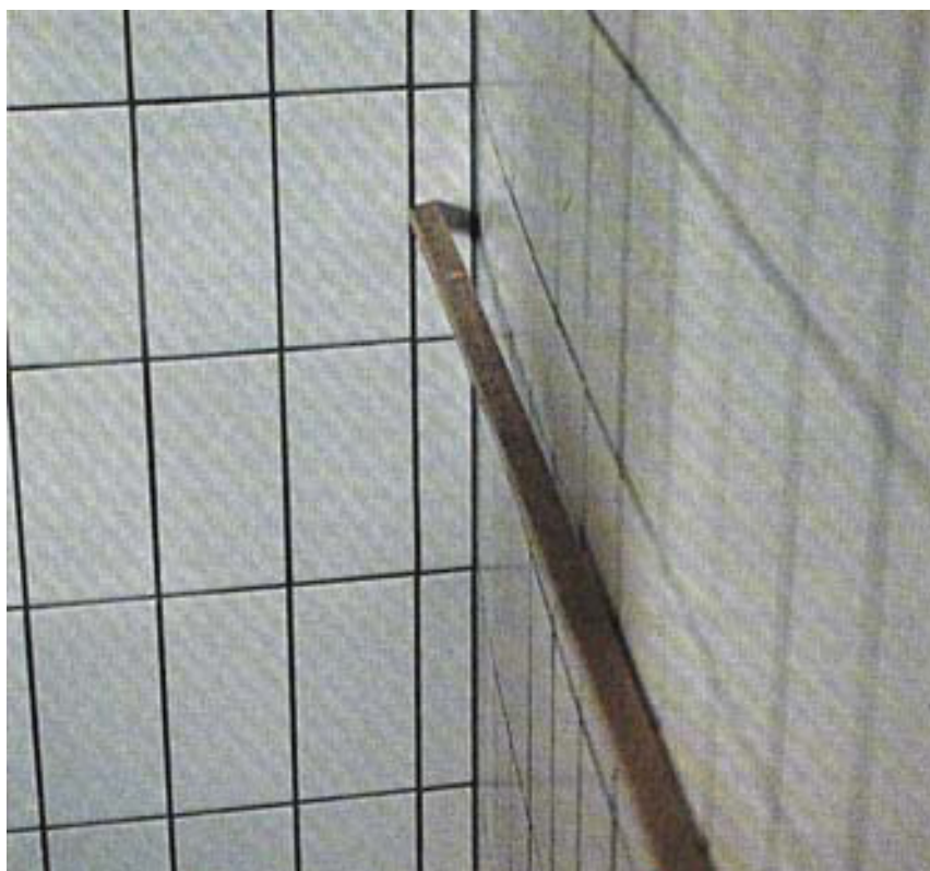
Fig. 1. Retholdt på udbøjet flisebeklædt spånpladevæg. Fugebevægelser i spånpladerne bag de keramiske fliser forårsager uacceptabelt store udbøjninger.
